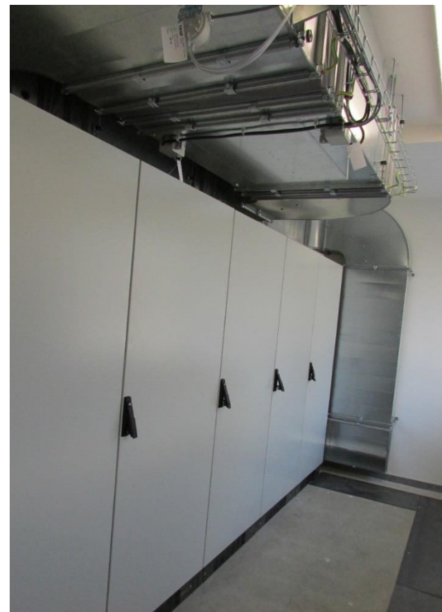
Výrobní areál (500 kWh)
