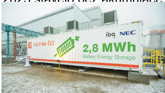
ČEZ, bateriové úložiště, elektrárna Tušimice, 2,8MWh
